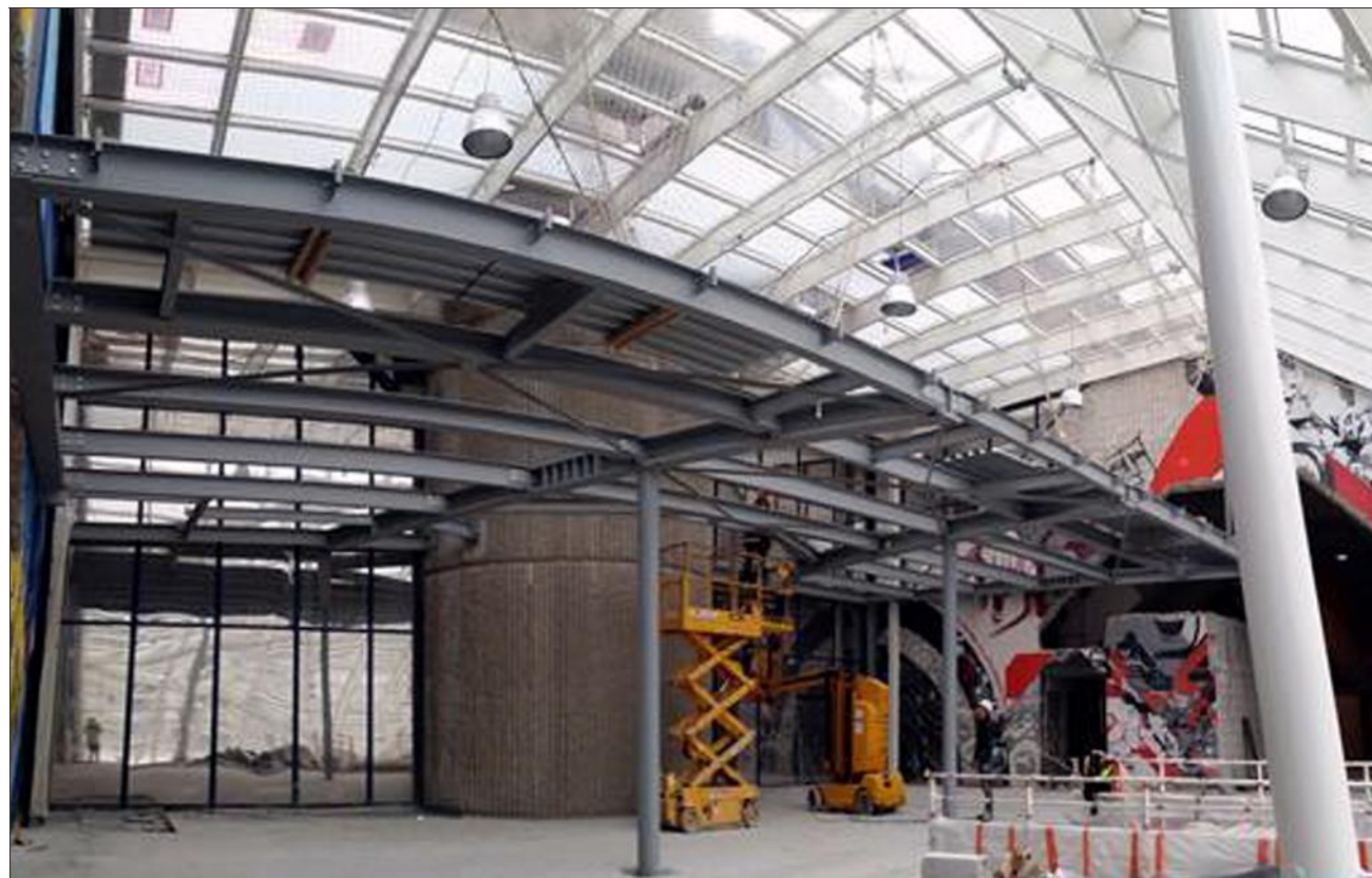
■ L'entreprise Waltefaugle a travaillé sur la création d'une verrière à l'entrée du Palais omnisports de Paris-Bercy.
